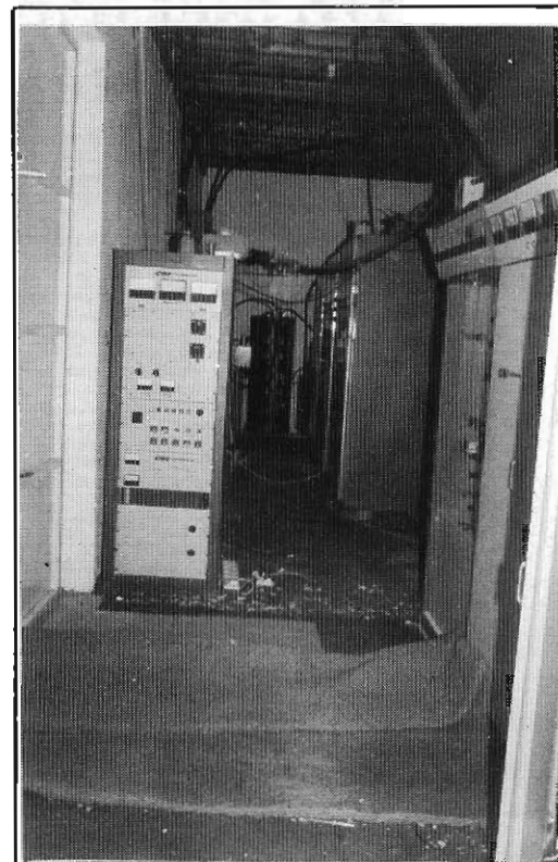
Zenderruimte Radio Nova
